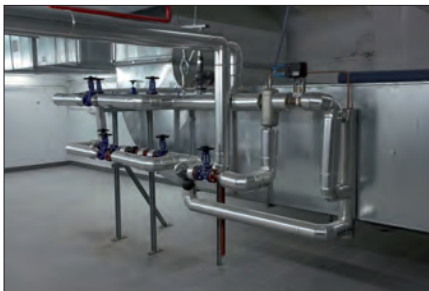
Dosificación de vapor en el aire de ventilación. Imagen propiedad de Torre Iberdrola AIE
