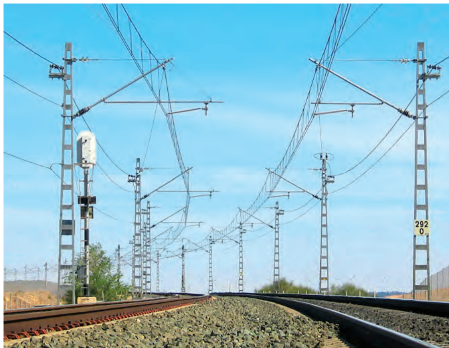
Fig. 3: Vía doble con catenaria convencional
