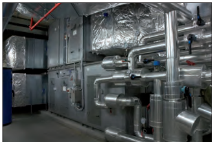
Imagen de una Unidad de Tratamiento de Aire de Ventilación. Imagen propiedad de Torre Iberdrola AIE
