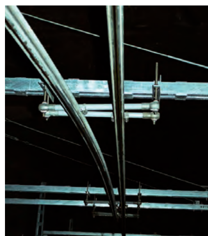
Fig. 9: Aguja aérea realizada con catenaria rígida
