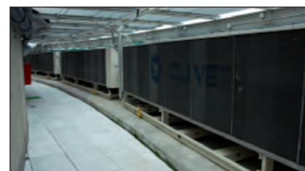
Aerorefrigeradores. Imagen propiedad de Torre Iberdrola AIE
