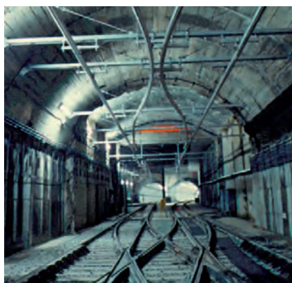
Fig. 4: Catenaria rígida instalada en un túnel
