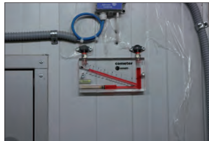
Medida de presión de aire para control de ventiladores. Imagen propiedad de Torre Iberdrola AIE
