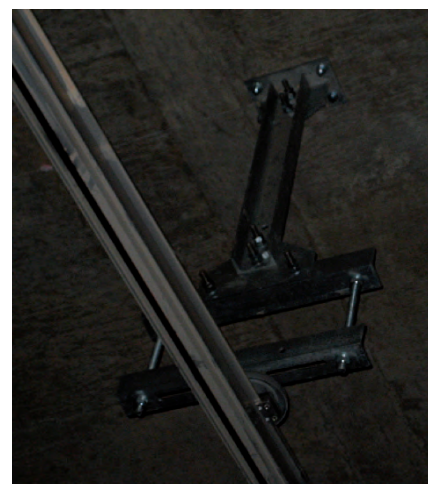
Fig. 5: Catenaria rígida en interior de túnel
