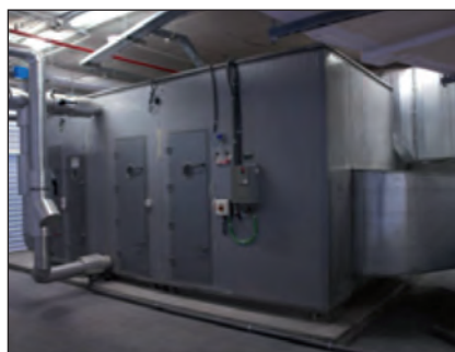
Unidad de tratamiento de aire del lobby. Imagen propiedad de Torre Iberdrola AIE
