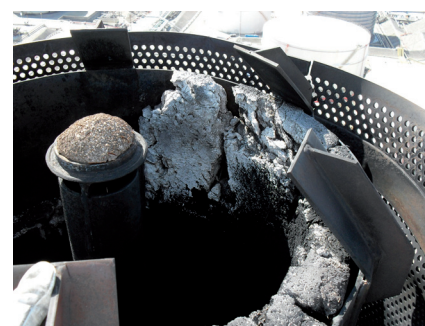
Fig. 8.1: Vista superior de un quemador instalado, con refractario desprendido
