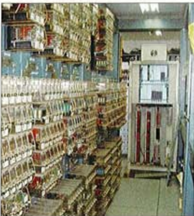
Enclavamiento de estación. Tecnología tradicional de relés
