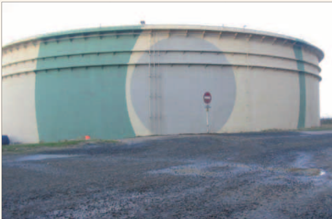
Figura 5: Tanque de almacenamiento de combustible
