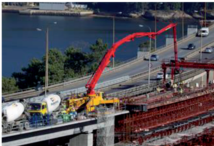
Fig. 2b. Clase de exposición IIIc. Ampliación del Puente de Rande en Vigo realizada con un CEM IV/A (V) N-SR de la fábrica de Toral de los Vados y CEM IV/A(V) 42,5 R-SR de las fábricas de Toral de los Vados y Oural
